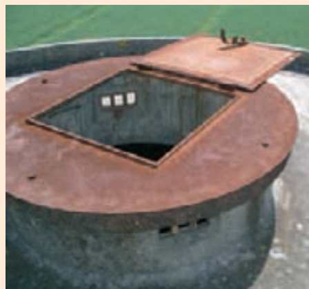
COUVERTURE SANS GARDE-CORPS, CAPOT DÉGRADÉ
