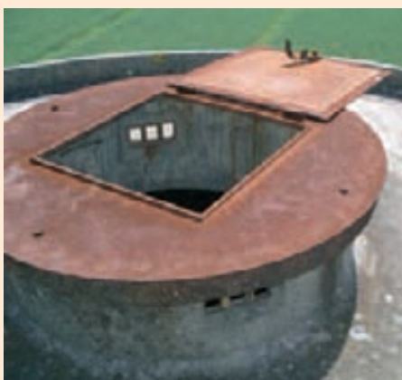
COUVERTURE SANS GARDE-CORPS, CAPOT DÉGRADÉ
